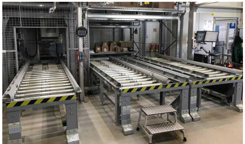
Einlagerstrecke für 2-Mast RBG mit überlanger Palette oder zwei Euro Paletten gleichzeitig
